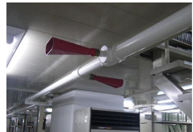
スプリンクラーの水を避け、ハロゲンガスによる消火設備
